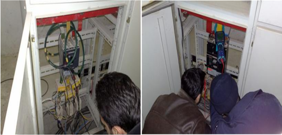
Resim 7.3. Akım klemplarının baralara bağlanmış hali (RUDOLF PAK 5 üç fazlı güç analizörü) ve Gerilim klemplarının bağlanması (ANALYST 2060 tek fazlı güç analizörü).
