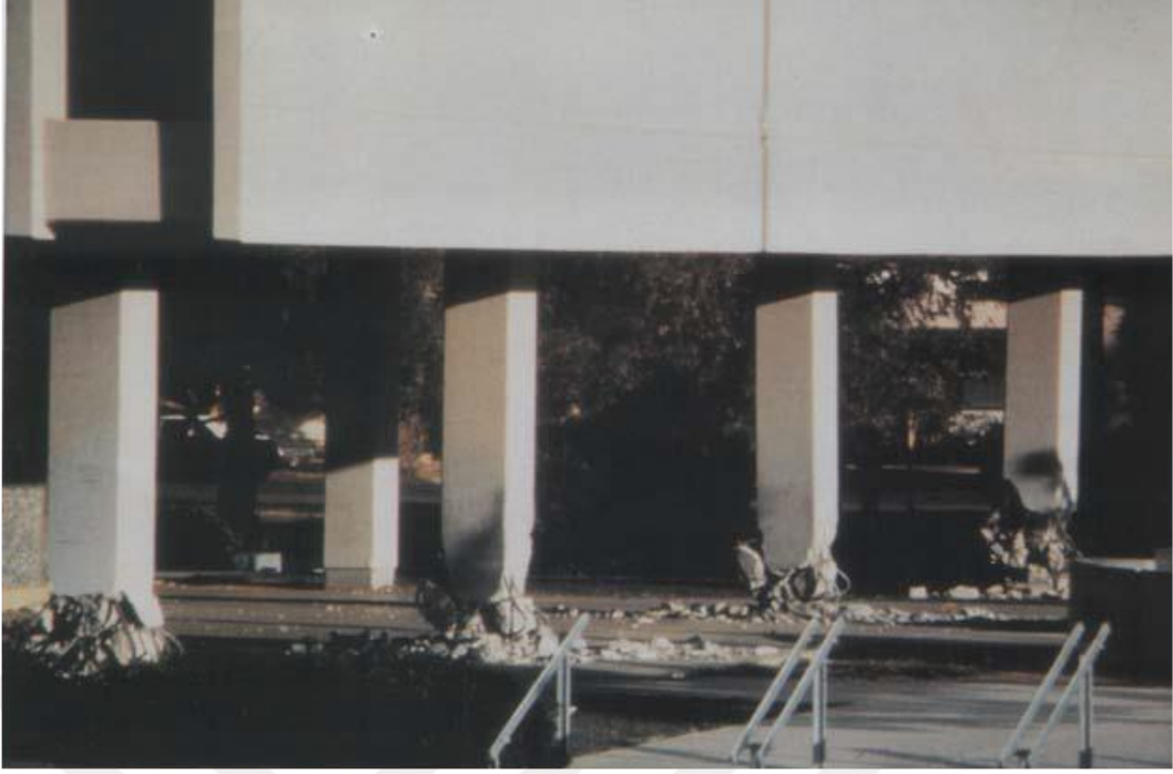
Şekil 1.18. Imperial County belediye binası zayıf kat hasarı, 1979 Imperial County depremi, M = 6,4 (Tezcan ve ark., 2007)
