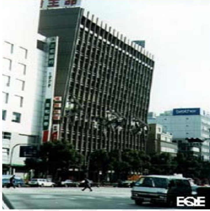
Şekil 1.20. Zayıf kat hasarı görmüş bina (Sandıkçı, 2014)
